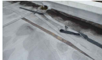
シート防水の浮きが発生し、内部に雨水が入り込んでいます。
