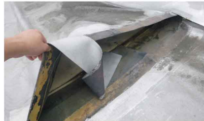
シート防水の接続部分の劣化により、シートの下に雨水が入り込んでいます。
